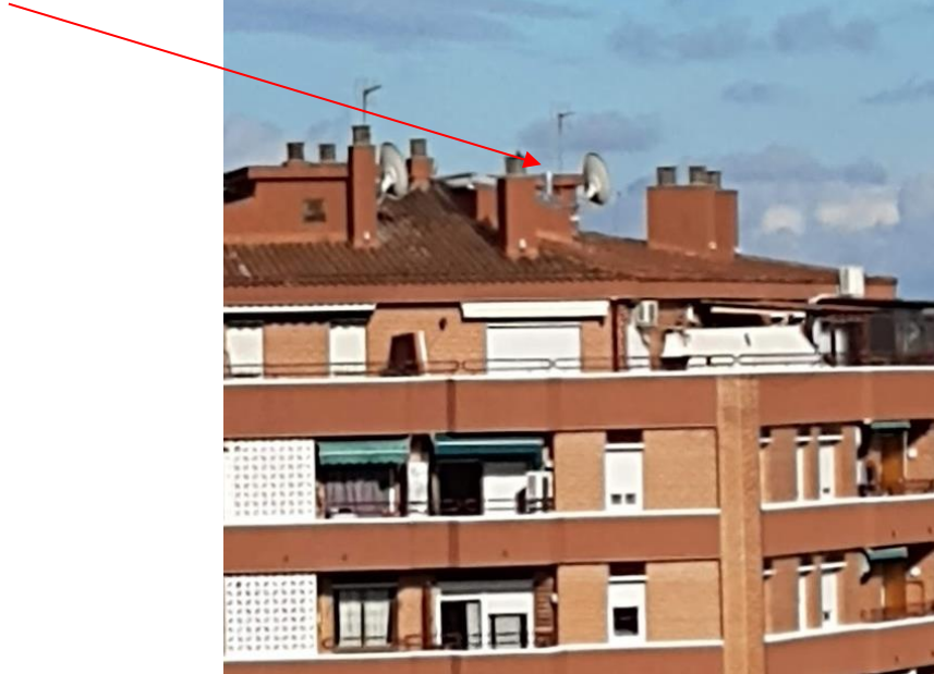
vista de conductos en cubierta
